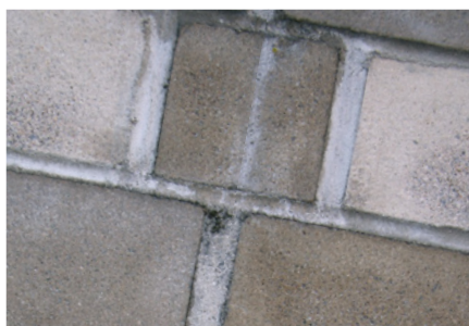
Niezabezpieczone (nie poddane czyszczeniu)
